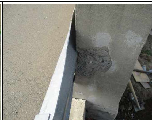
상행선 S1 콘크리트 박락
