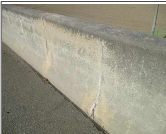
상행선 S1 균열
