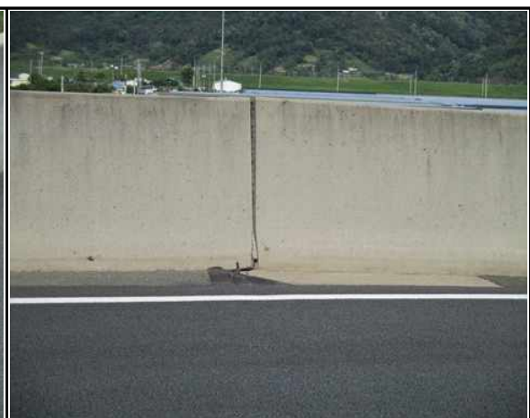
하행선 S1 중앙분리대 박락
