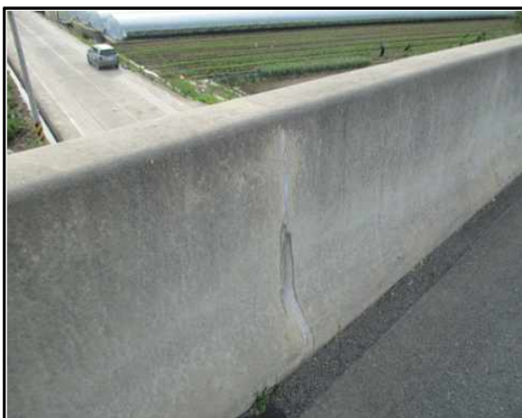
하행선 S1 균열 및 백태
